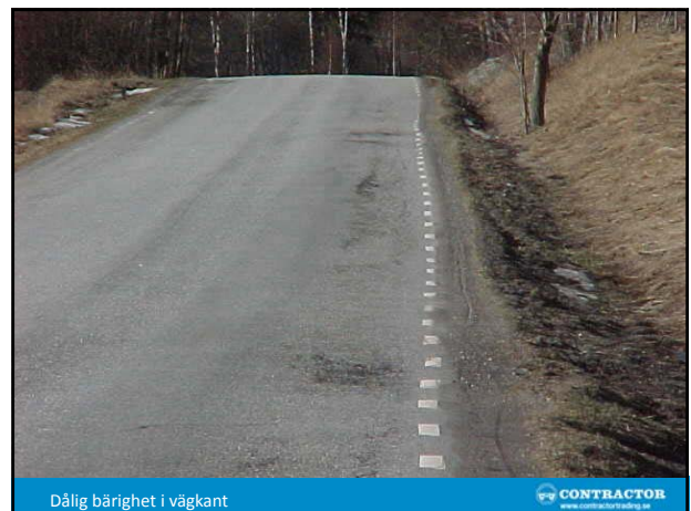
Dålig bärighet i väggkant
