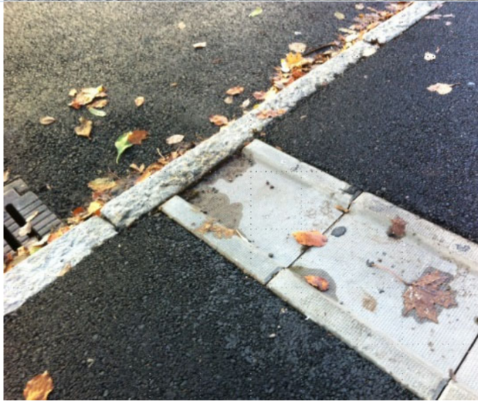
Felplacerad rännal samt fel anslutning mot kantsten
