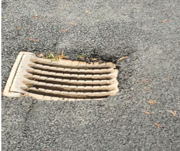
Gamla trasiga betäckningar i rännal, samt dålig packning och separerad beläggning
