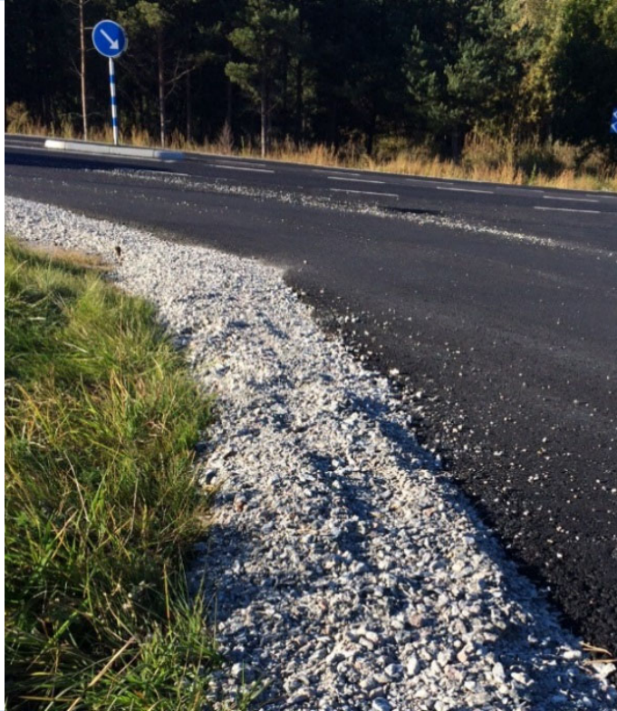
Dåligt utförda stödremсор
