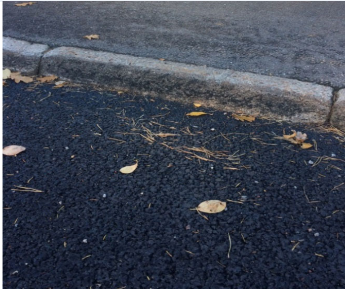
Separation och öppna ytor, samt klister på kantsten
