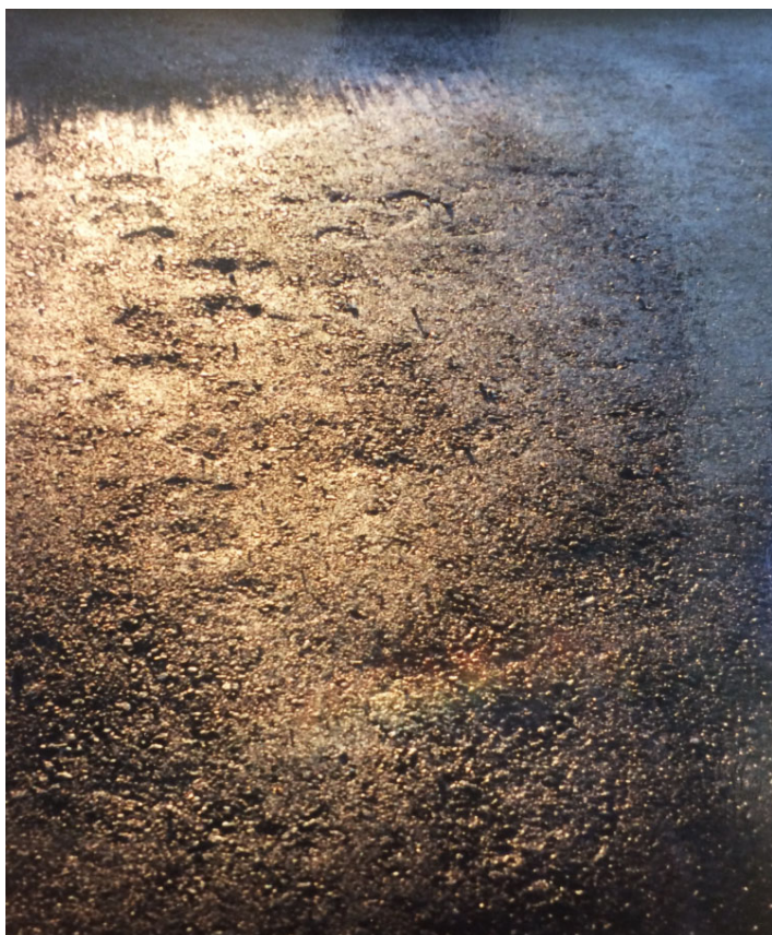
Handlagd yta med dålig packning
